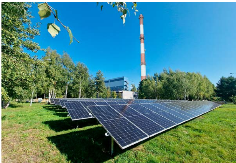
Panele fotowoltaiczne na terenie Ciepłowni Radzionków.
