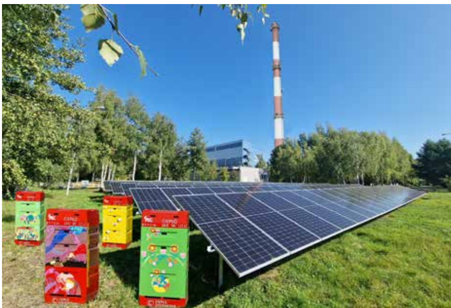
Panele i pasieka na terenie Ciepłowni Radzionków.
