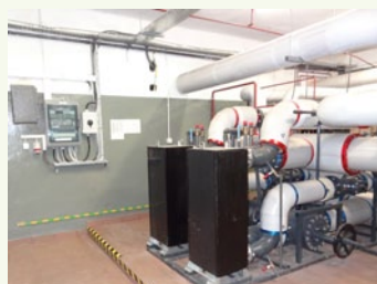
Nowoczesny grupowy węzeł cieplny
