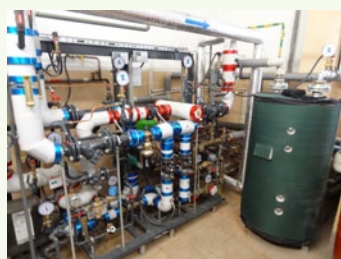
Nowoczesny indywidualny węzeł cieplny
