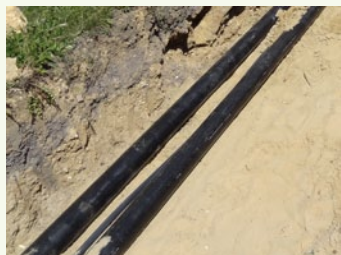
Osiedlowa zewnętrzna instalacja odbiorcza po przebudowie
